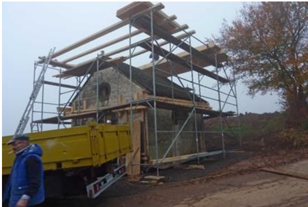
Während den Sicherungsarbeiten wurde die komplette Kapelle mit einem Gerüst und einem Schutzdach eingehaust.
